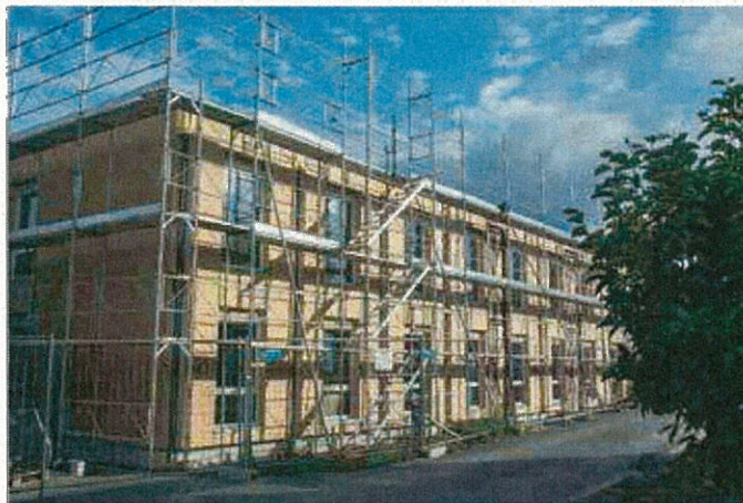
Hier, la ville a inauguré le chantier du «Patio», aux Prés-de-Vidy. ARC
